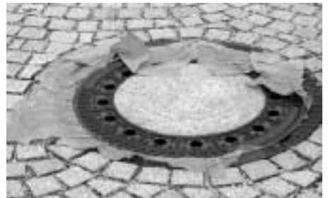
Ein Kanaldeckel in Bad Reichenhall, mit Folie gegen den impertinenten Gestank verschlossen. Sicher keine Dauerlösung!
